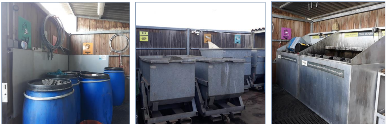
Figure 3. Contenants pour DID, DIB et cuve à huiles usagées
